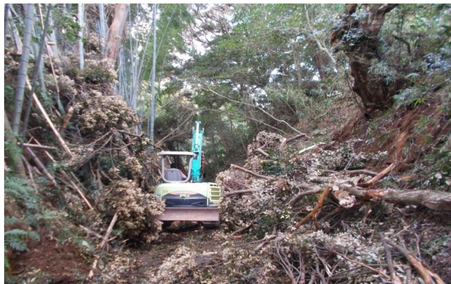
倒木片付け中の重機
