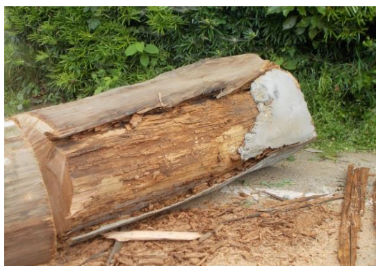
解体後の腐食した鳥居
